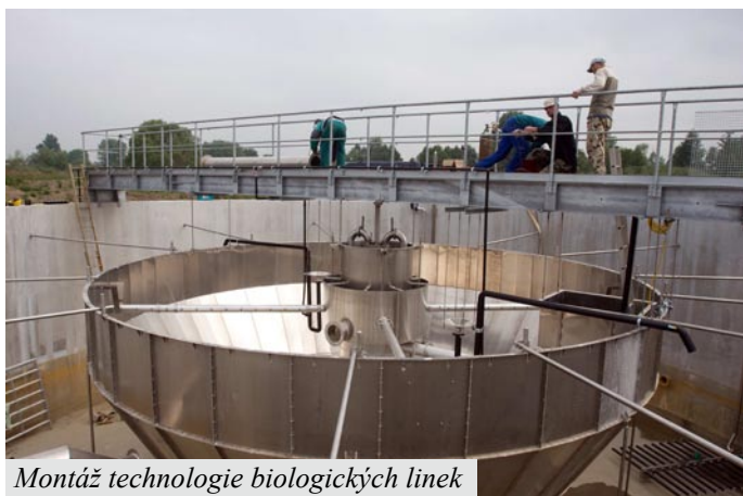
Celkový pohled na ČOV a biologické linky
